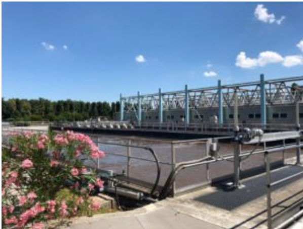
La station d'épuration du Gruppo Cap à Bresso
